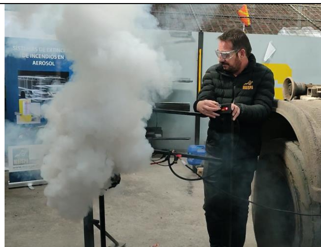
Activación del sistema
